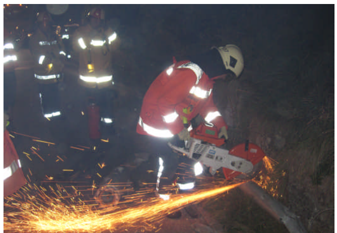
Der Kandalaber muss von der Strasse entfernt werden
