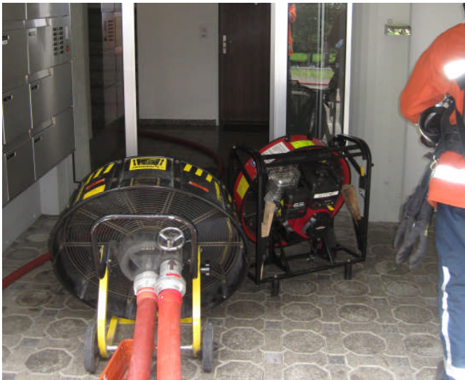
Zur Entrauchung werden zwei Lüfter eingesetzt
