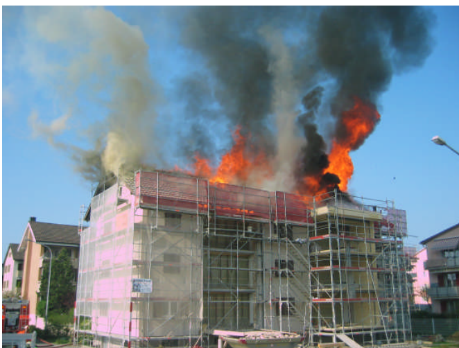
Der Dachstock steht beim Eintreffen in Vollbrand
