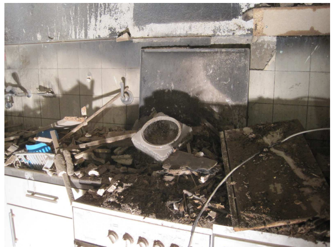
Schaden in der Küche
