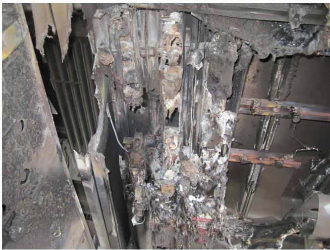
Das total verschmorte Schalttafel
